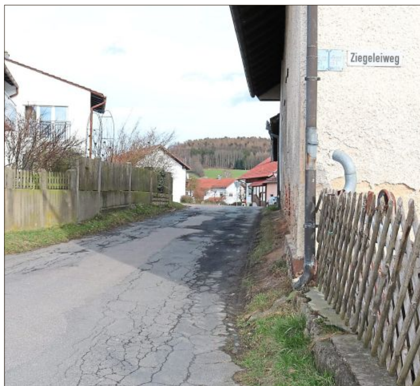
Die Schäden an der Straße sind offensichtlich.
